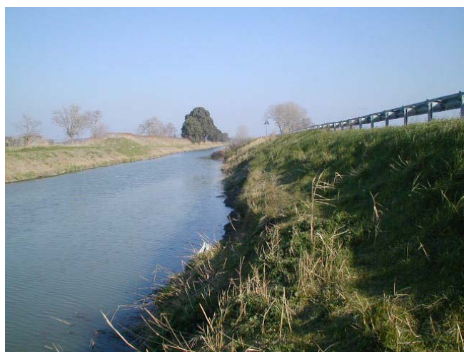
COLLETTORE GENERALE DELLE ACQUE BASSE-Argine Sx
