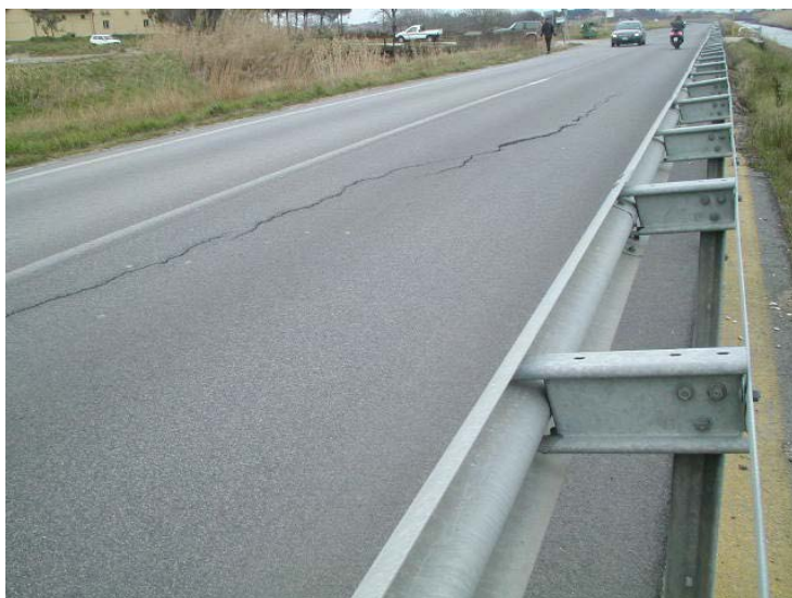
VIA DELLE IDROVORE DI FIUMICINO - cedimenti struttura stradale
